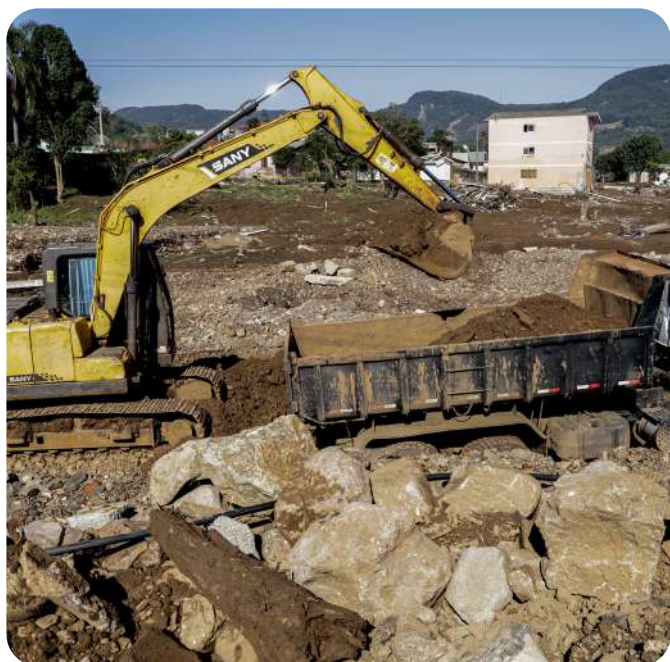
Retroescavadeira faz limpeza de terreno em frente a casas destruídas após enchente que atingiu região de Roca Sales, no Rio Grande do Sul
